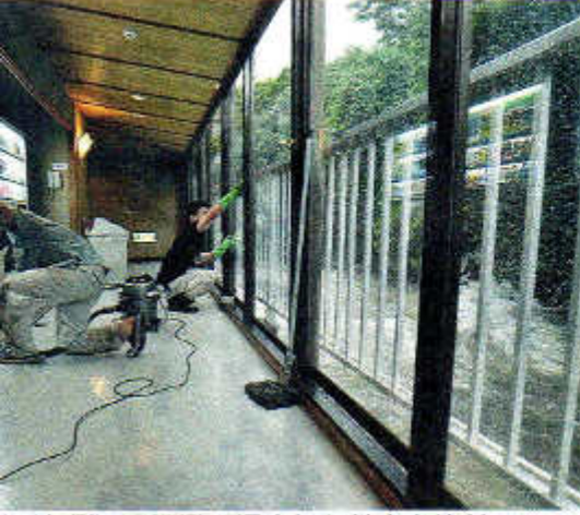
(右側)の氾濫で浸水した館内を片付けた従業員ら＝津市榊原町の湯元榊原館で
